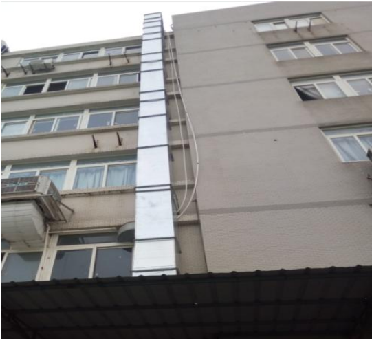
废气收集管道
