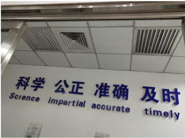
盐雾实验室密闭车间集气口
